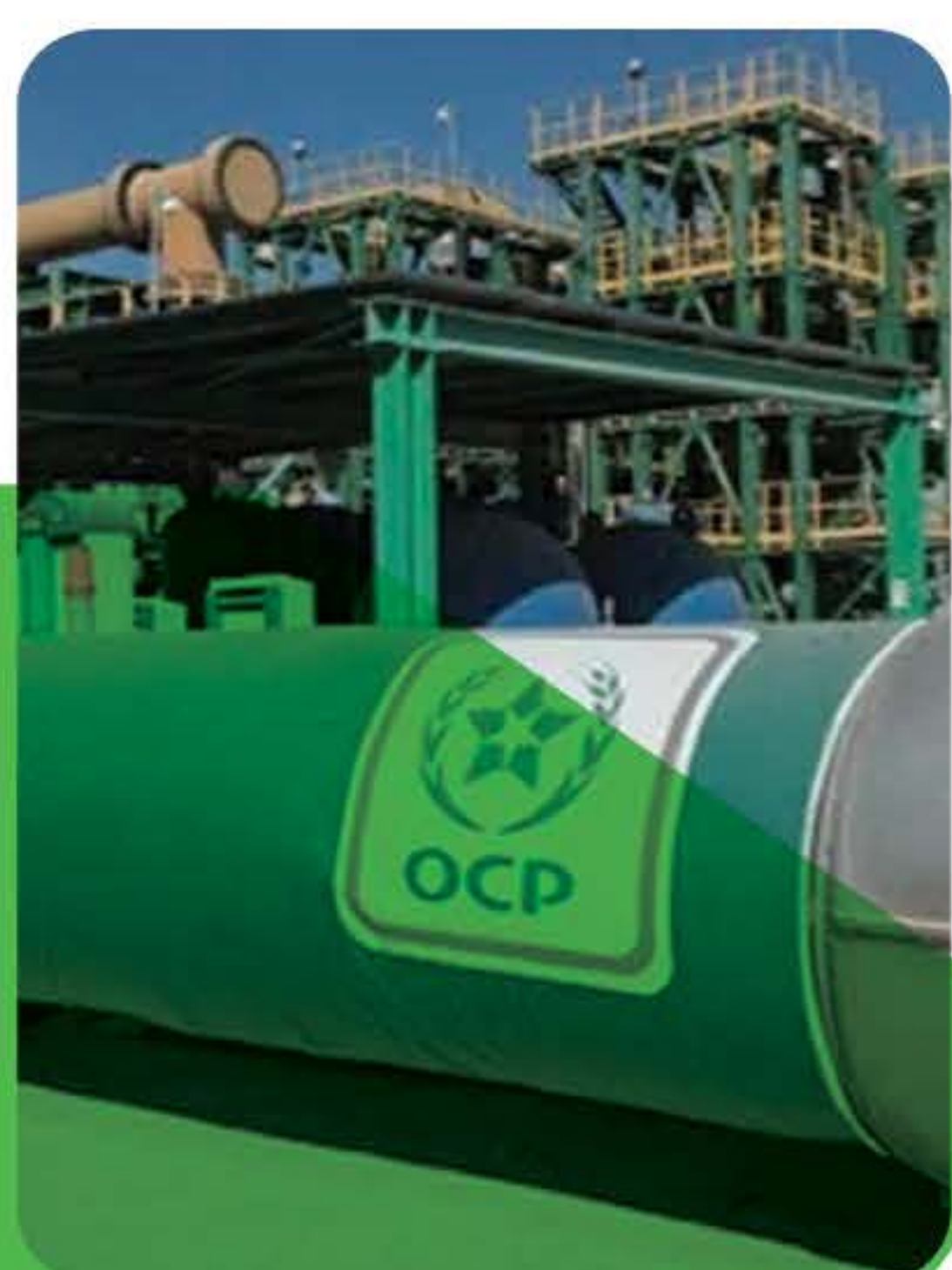
OCP Jorf Lasfar Dépoussiérage trémie 55 000 m 3 /h
